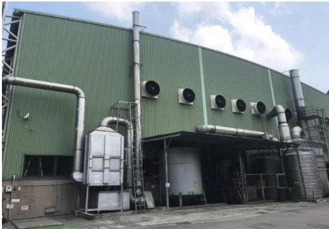
【大里廠空氣污染防制設備】
