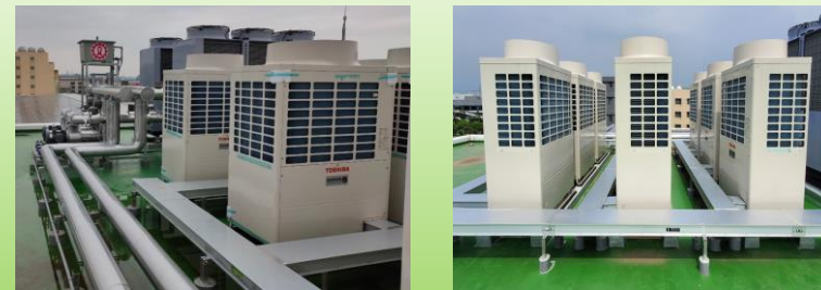
嘉義三廠-變頻多聯式空調設備
